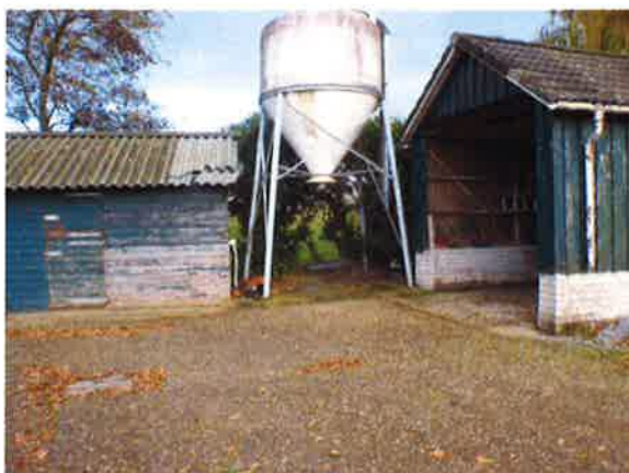
Afbeelding 14: Opstallen met asbestverdacht materiaal
