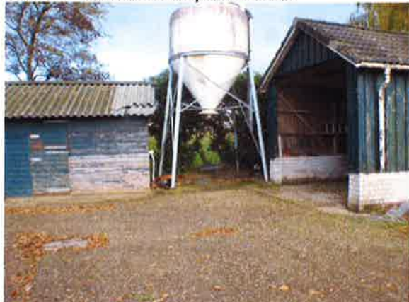
Schuur met asbestverdacht plaatmateriaal
